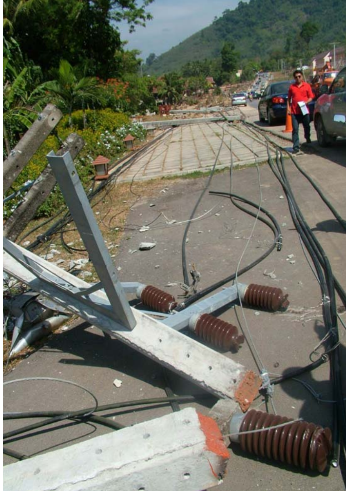
รูป 3.25 เสาไฟฟ้าหักโค่นบริเวณถนนบ้านเขาหลัก ต.คึกคัก อ.ตะกั่วป่า จ.พังงา เนื่องจากแรงปะทะจากสึนามิและทำให้โครงสร้างต่างๆจมอยู่ใต้น้ำ ไฟฟ้าดับส่งผลให้เครื่องจักรและเครื่องใช้ไฟฟ้าใช้งานไม่ได้ (ภาพโดย ภาควิชาธรณีวิทยา คณะวิทยาศาสตร์ จุฬาลงกรณ์มหาวิทยาลัย)
